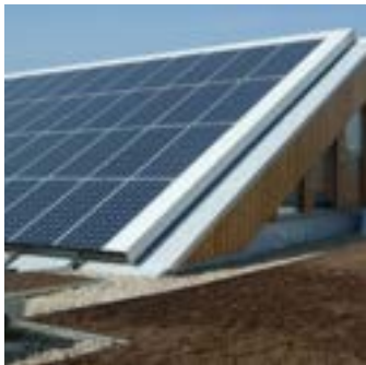
Toiture panneaux solaires
